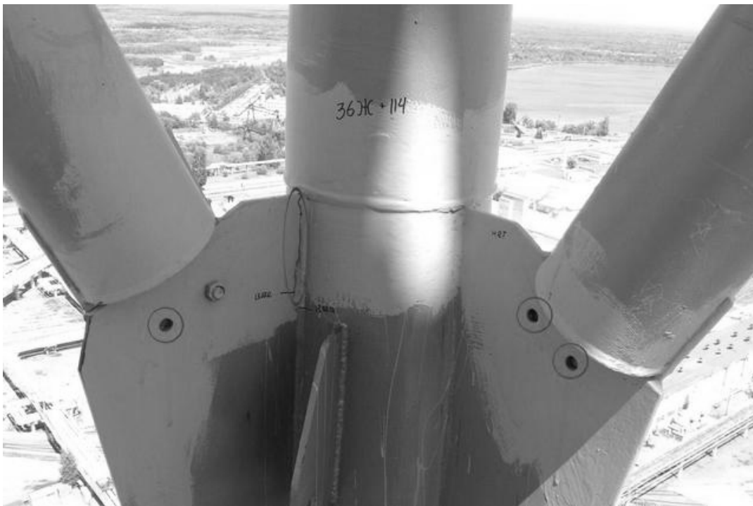
Рис. 1.8. Відсутність болтових з'єднань нової вентиляційної труби (НВТ-2) Чорнобильської АЕС / Absence of bolted connections of the new ventilation pipe (NVP-2) at the Chernobyl NPS
