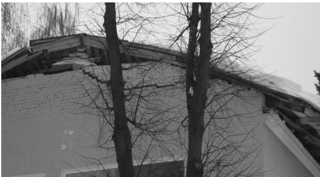
Рис. 1.3. Обвалення даху дитячого будинку, м. Чернігів / Collapse of the roof of kindergarten in Chernihiv
