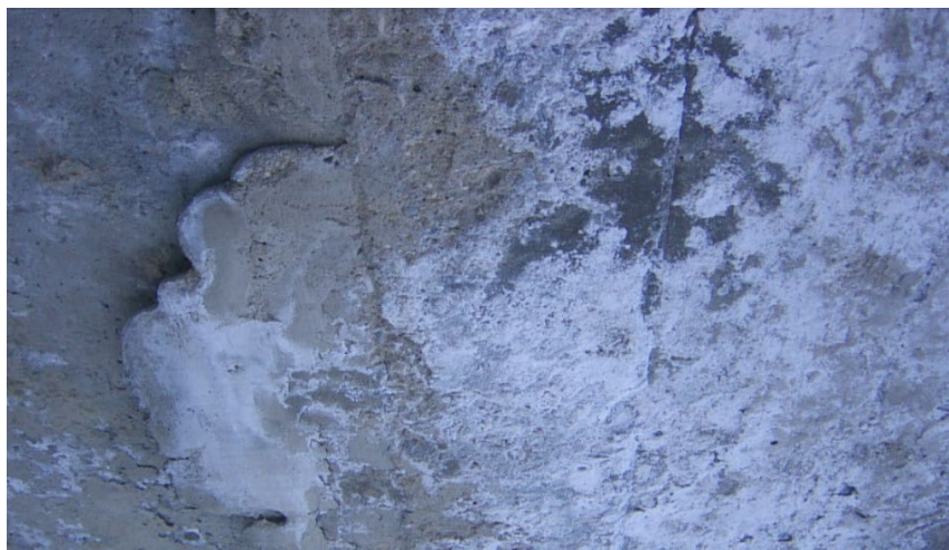
Рис. 2.11. Корозія бетону внаслідок вилуговування / Concrete corrosion due to leaching
