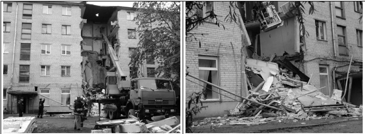
Рис. 1.6. Обвалення п'ятиповерхового будинку м. Луцьк / Collapse of a five-story building in Lutsk
