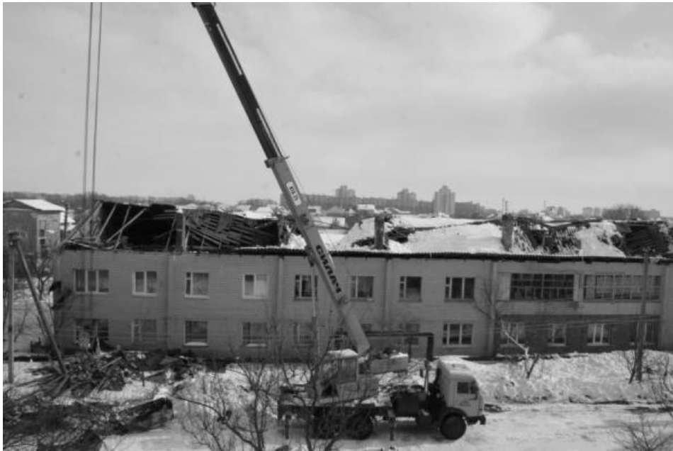
Рис. 1.2. Обвалення даху багатоквартирного житлового будинку, м. Чернігів / Collapse of the roof of an apartment building, Chernihiv
