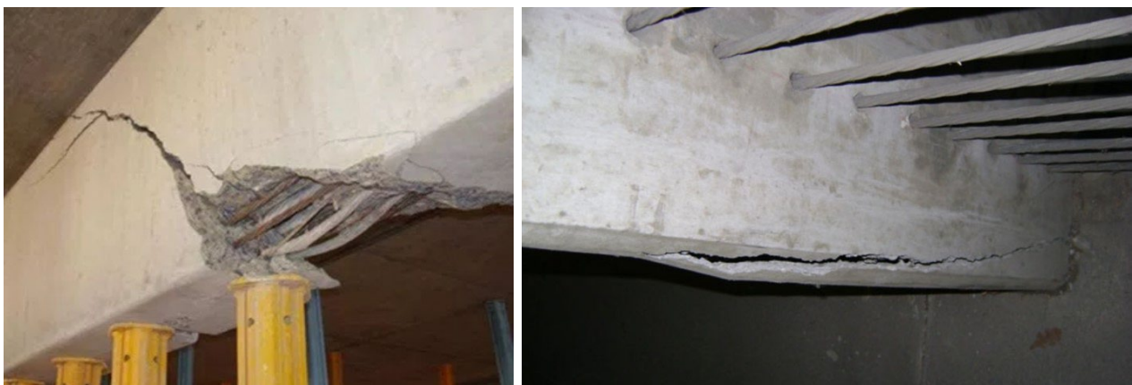
Рис. 2.1. Руйнування несучих елементів залізобетонних конструкцій під дією перенавантажень / Destruction of load-bearing elements to reinforced concrete structures under overloads
